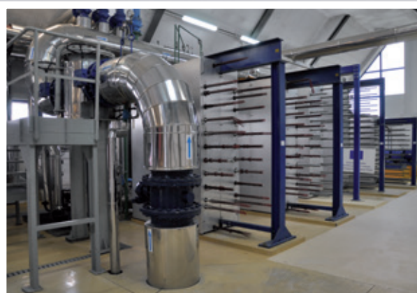
Wymienniki w Ciepłowni Geotermalnej w Bańskiej Niżnej
