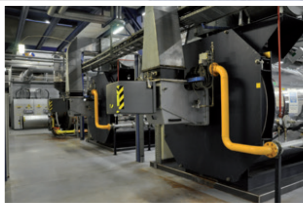
Kotłownia Centralna w Zakopanem
