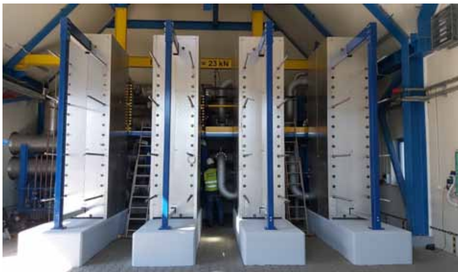
Wymienniki ciepła w Ciepłowni Geotermalnej
