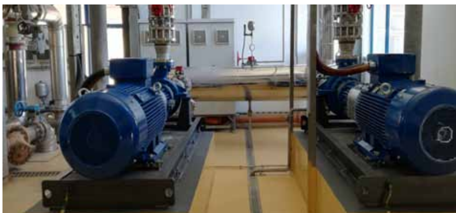
Pompy wspomagające w Ciepłowni Geotermalnej
